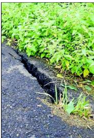
Ein tiefer Riss klapft im Asphalt des Rheinufers in Widdig.
