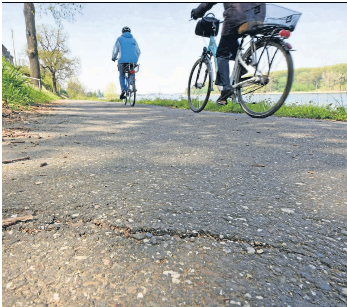
Risse im Asphalt deuten darauf hin, dass das Bornheimer Rheinufer in Bewegung ist.
