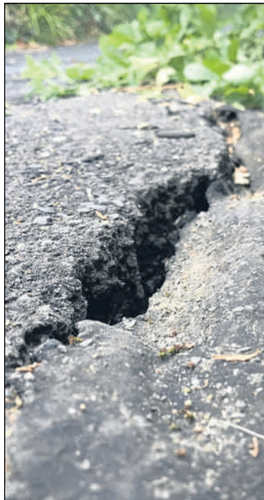
Einer von vielen Rissen im Rhein-uferweg.
