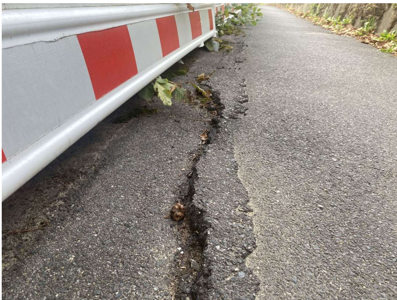
Tiefer Riss: Der Asphalt auf dem Rheinuferweg bricht in Richtung der Böschung zum Rhein hinunter weg, Foto: Christoph Meurer
