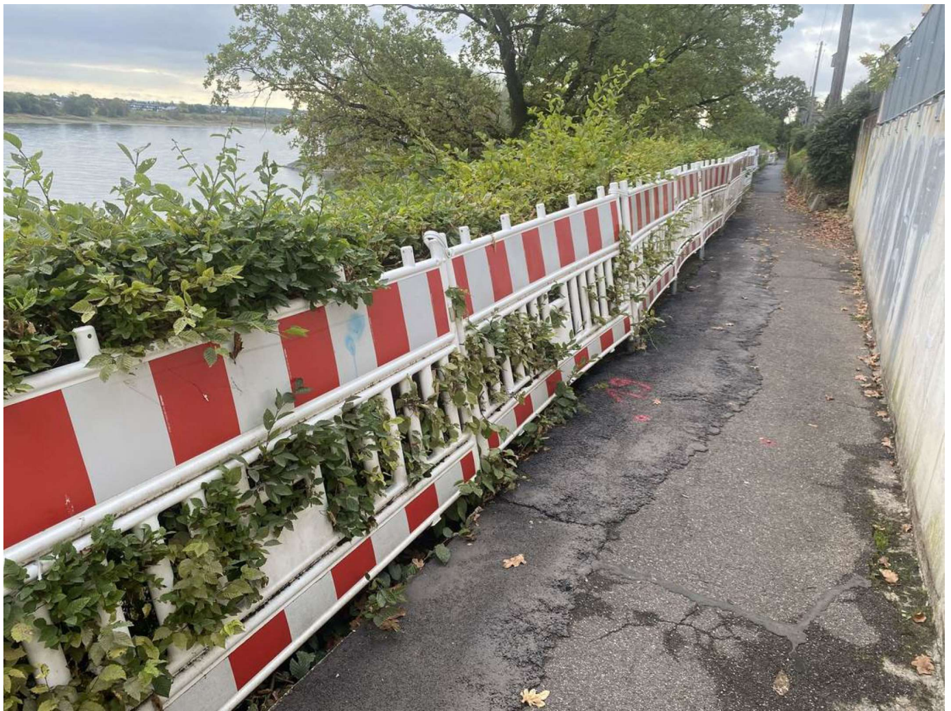
Auf dem Rheinuferweg ist zu erkennen, wie oft der Asphalt schon geflickt wurde.
