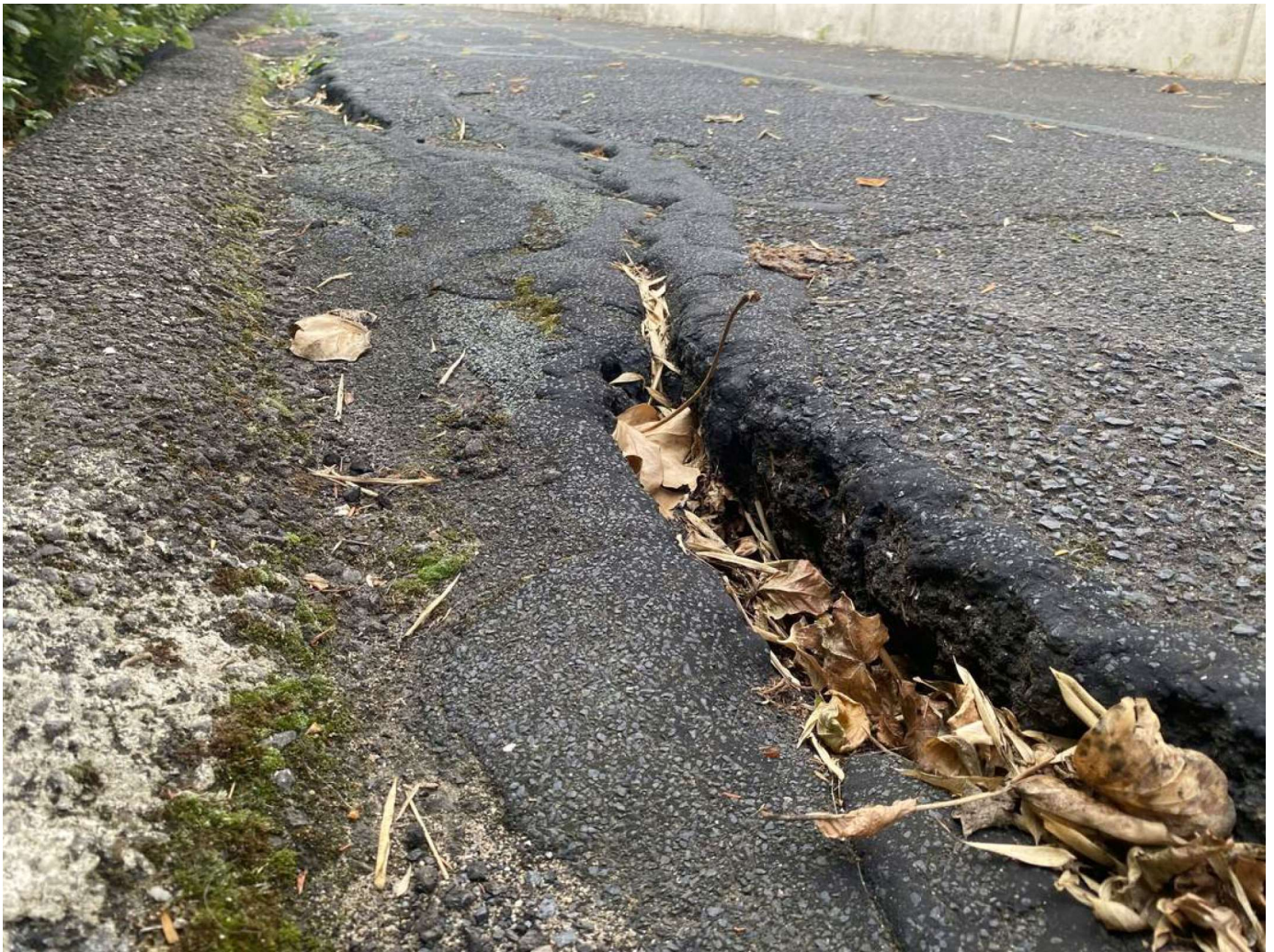
Die teils tiefen Risse sind seit Monaten nicht geflickt worden.
